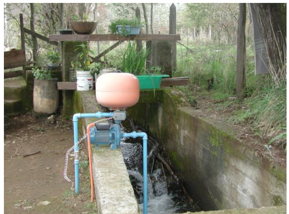
Bomba de agua, canal (hidroestructura)
