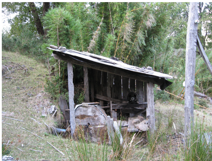
Figura 21. Molino de agua, construido hace 30 años para generar electricidad de uso doméstico, hoy no se encuentra en condiciones de ser utilizado.
