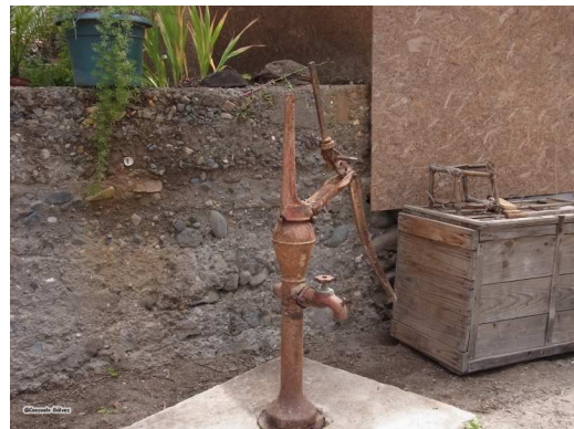
Figura 64 Bomba manual de extracción de agua, Los Choros.
