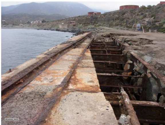
Figura 31 Ruinas de instalaciones postuarias caleta Chungungo.
